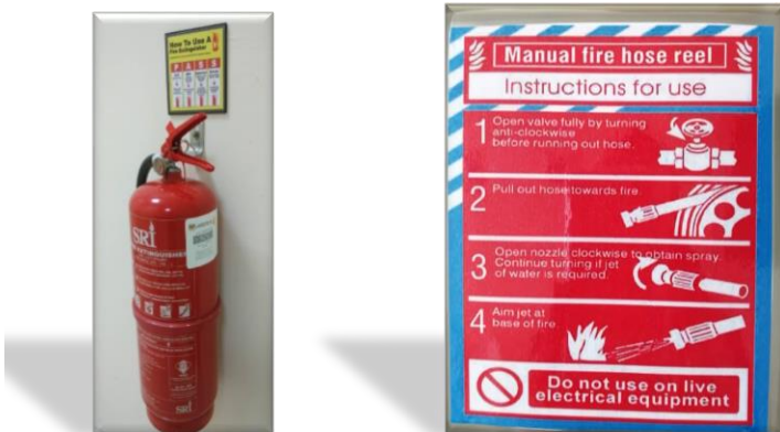
Peralatan Pencegahan Kebakaran
